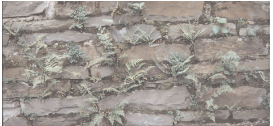
Bewuchs einer Kirchhofmauer: Zu sehen sind die schmalen Wedel des Braunstieligen Streifenfarns, die kompakten „Sträußchen“ der Mauerraute und unten die dreieckigen Wedel des Zerbrechlichen Blasenfarns. Nur Gehölze wie der Birken sämling rechts oben oder wie Efeu stellen eine Gefahr für die Mauer dar, da sie - im Unterschied zu den krautigen Pflanzen - durch das Dickenwachstum ihrer Stämme und Wurzeln die Mauer sprengen können.
